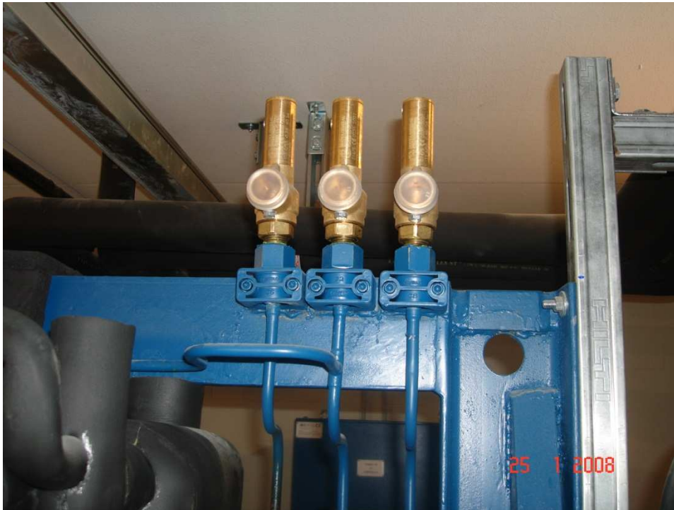
Válvulas segurança CO 2 instaladas no Rack
