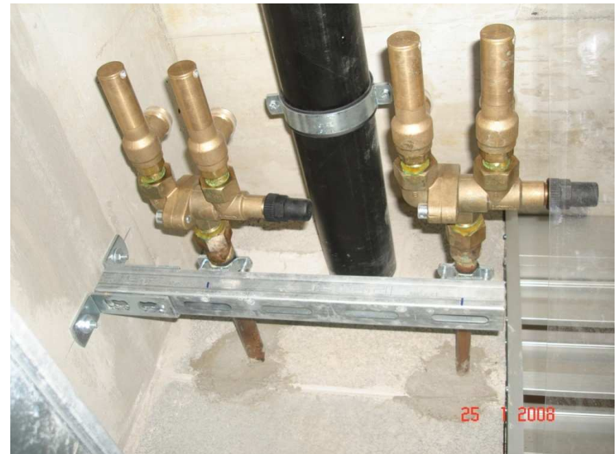
Válvulas instaladas no lado de fora da sala de máquina
